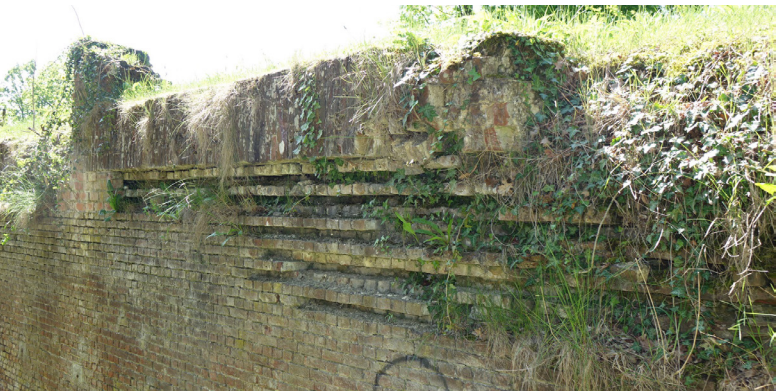
afb. 164: Uitvallende bakstenen en plantengroei aan de bovenzijde van bastion 4 © Origin
