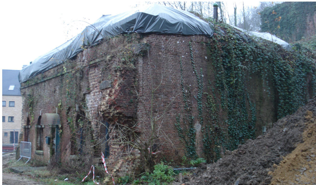
afb. 76: Zicht op wachtlokaal voor het volledig bedekt was met klimop. Schade aan baksteen metselwerk wordt duidelijk op foto © Origin
