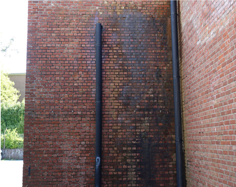
afb. 157: Vochtprobleem courtine 1-2 nadat dakopbouw veranderd is ©Origin
