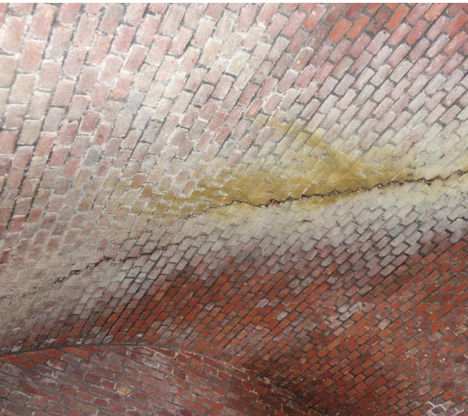
afb. 176: Bast en zoutuitbloeiing plafond gesitueerd uiteinde bastion 4 (noordzijde) © Origin
