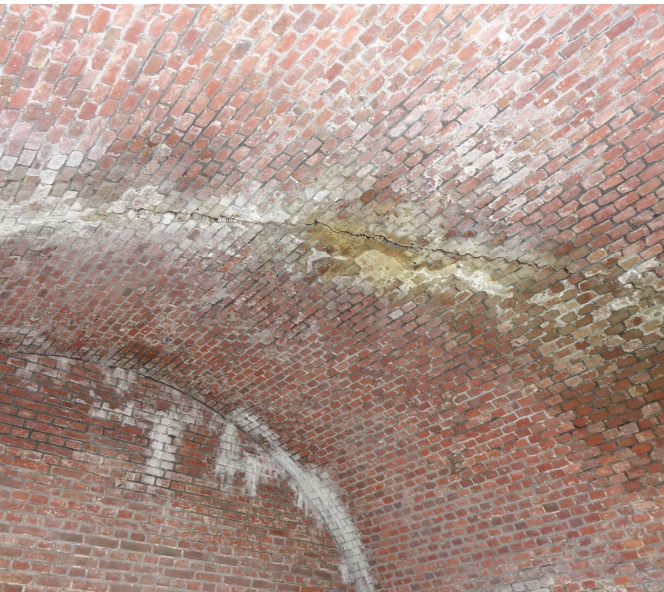
afb. 178: Barst in plafond en zoutuitbloeiing gesitueerd uieinde bastion 3 (noordzijde) © Origin
