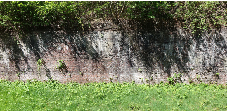
afb. 170: Zouten op muur van de tenaille (zijde tenaillegracht) © Origin
