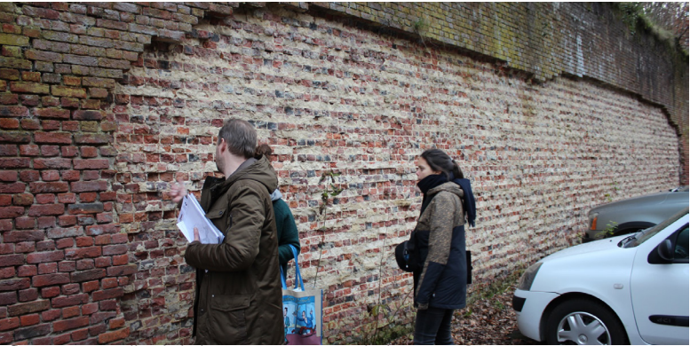
afb. 163: Uitvallende bakstenen contrescarp thv bastion 2 © Origin
