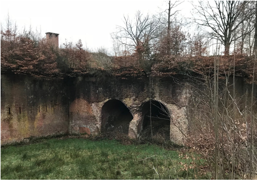
afb. 64: Metselwerk is zwaar beschadigd, 1 van de openingen werd toegemetsd © Origin
