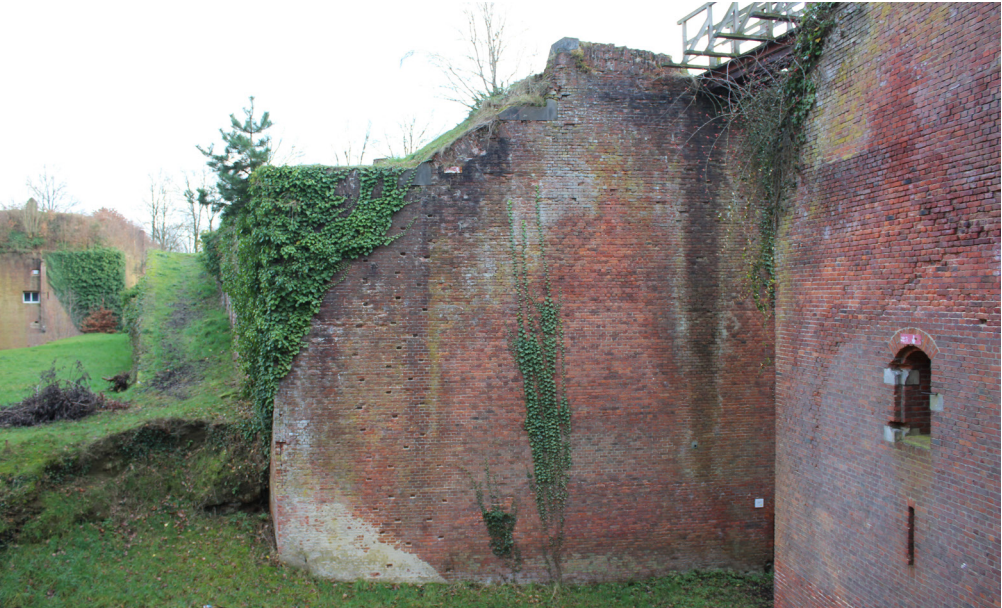
afb. 160: Vochtschade flank tenaille voor courtine 3-4 © Origin
