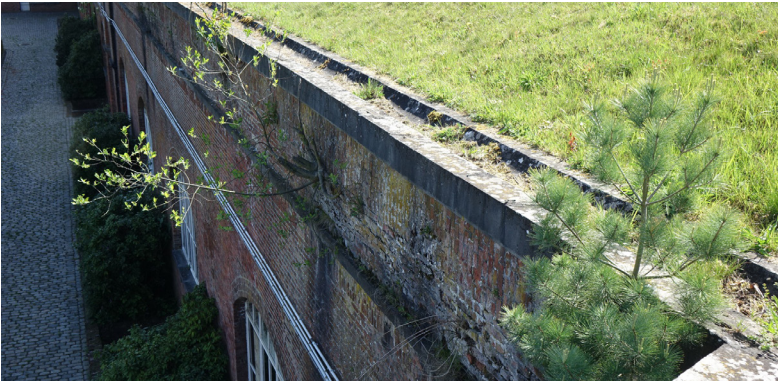
afb. 166: Plantengroei bovenzijde metselwerk van de courtine © Origin
