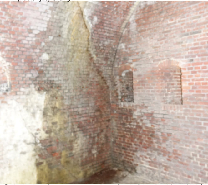
afb. 177: Twee barsten muren, gesitueerd uiteinde bastion 4 (noordzijde) © Origin
