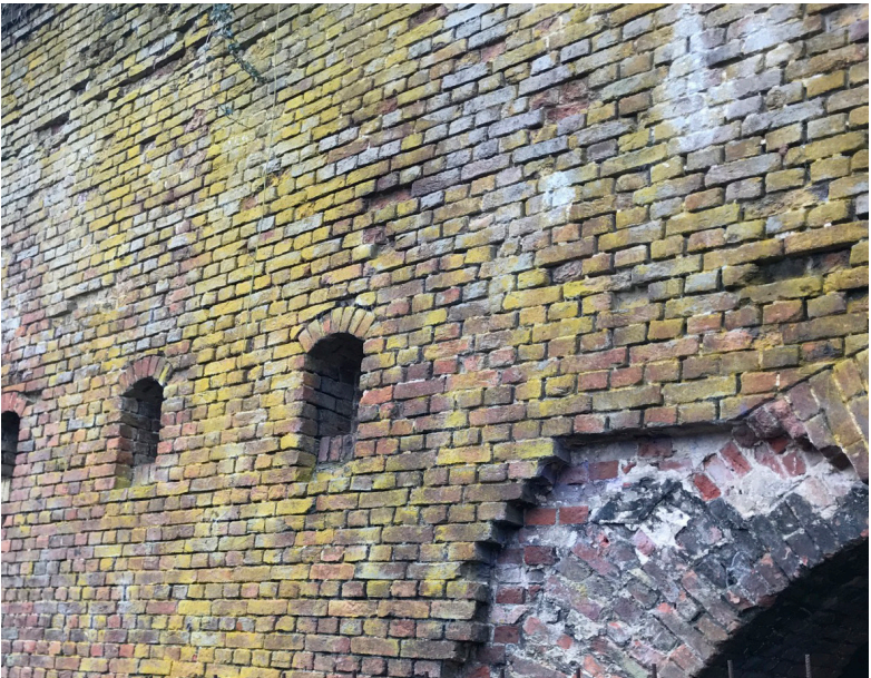
afb. 162: Verweerde voegen gekazemateerde artillerietoren © Origin
