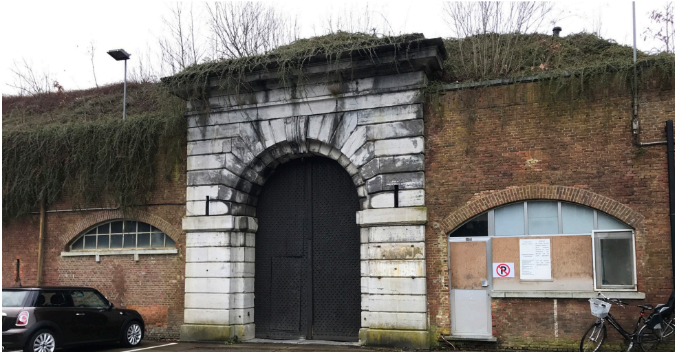
afb. 225: De begroeiing op courtine 1-2 strookt niet met de begroeiing op de rest van de courtine-daken. Courtine 1-2 werd aangeplant met struiken en hardbladige vegetatie / bodembedekkers terwijl de overige daken bedekt zijn met grassen © ORIGIN
