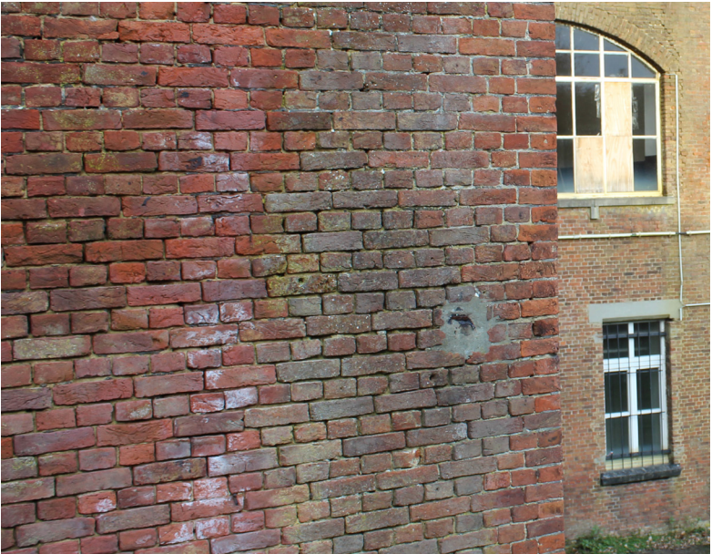
afb. 161: Verweerde voegen bastion 4 © Origin
