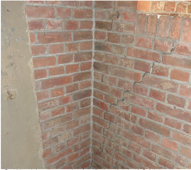
afb. 175: Scheur in gereneleerde galerij van bastion 2 © Origin
