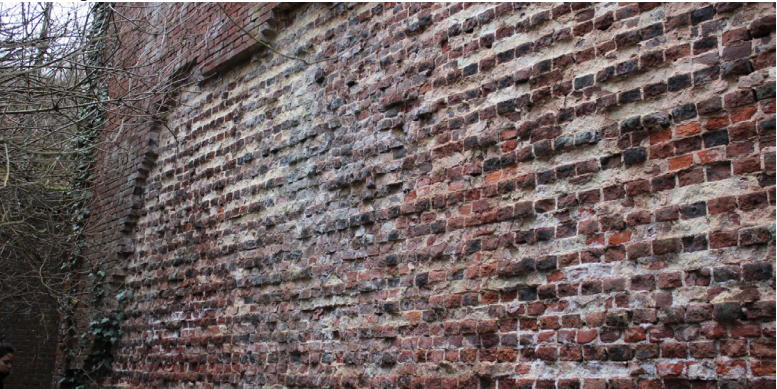
afb. 165: Uitvallende bakstenen thv zijgevel lage batterij © Origin
