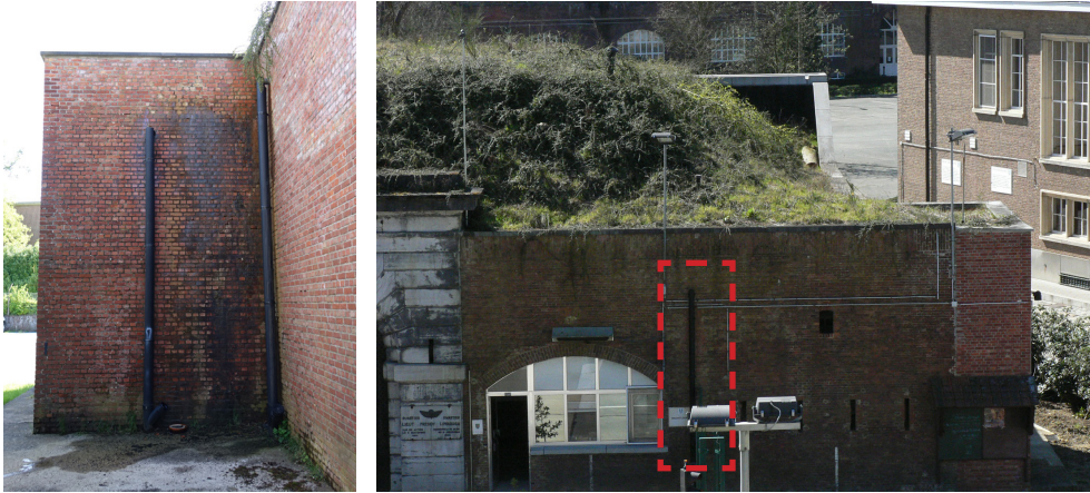
afb. 227: Ingrep regenwaterafvoer aan courtine 1-2 (pegasus-museum) - Afvoerpijpen zichtbaar tegen gevels, elders zijn de hemelwaterafvoeren niet zichtbaar. 2018. © ORIGIN
