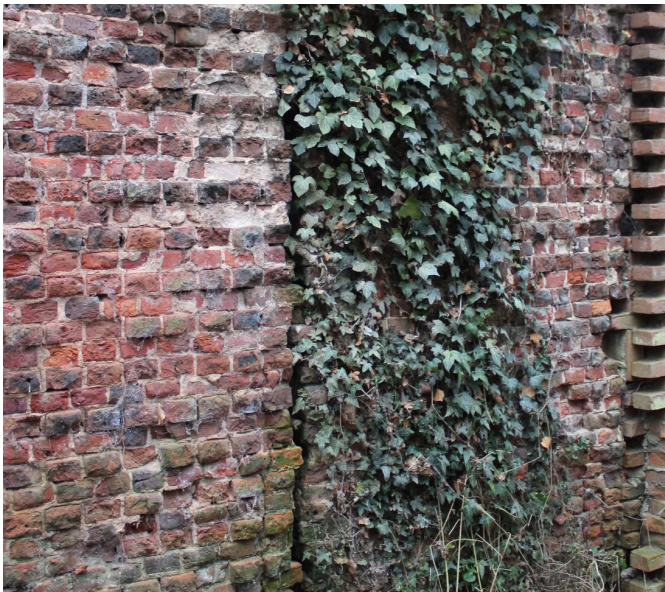
afb. 174: Scheur metselwerk zijgevel lage batterij © Origin
