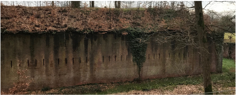
afb. 224: Dakbegroeiingen aan de dakranden - sterk verweerde dakranden - dekstenen en onderliggende bakstenen worden weggeduwd met vochtschade in het interieur tot gevolg. 2018. © ORIGIN
