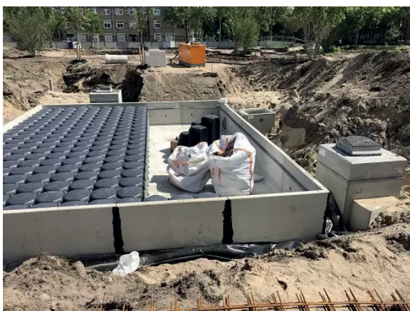
Het watershell systeem met een ondergrondse bufferkelder
